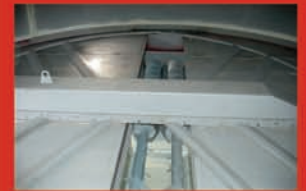
Extractores mecánicos e hidráulico
