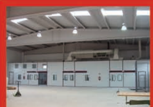
Cabinas presurizadas de barnizado
