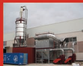
Baterías de filtros
