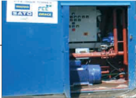
[Fig. 5] .- Detalle sala de bombas.
