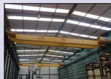
Puentes grúa JASO de 20 toneladas y 19 metros. Años 2001 a 2005
