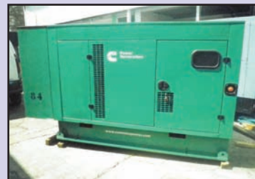
Grupo electrógeno insonorizado de 150 KVA
