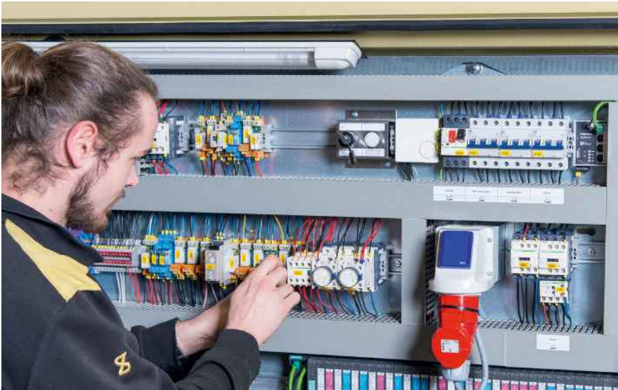
REX 100 en la cabina de control de la grúa
