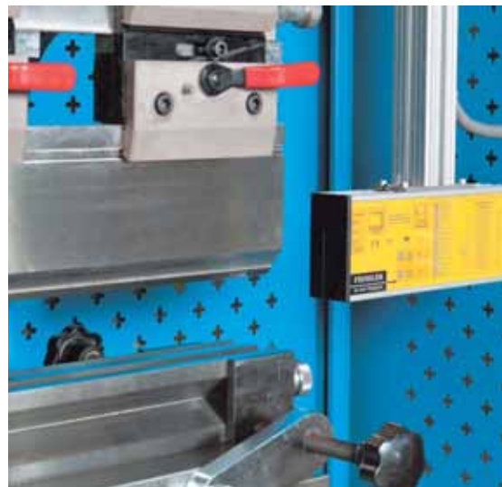
sistema de seguridad
