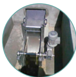
reja de desbaste automática
