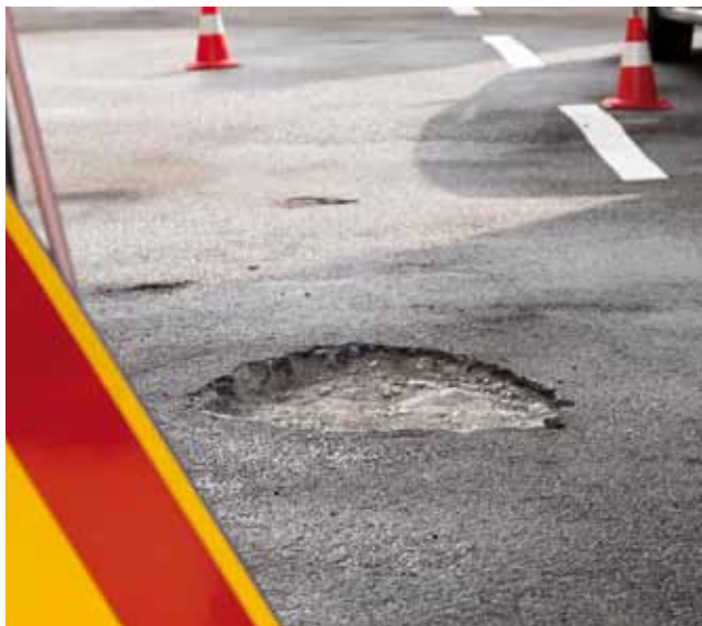
1. Bache en carretera listo para ser reparado
