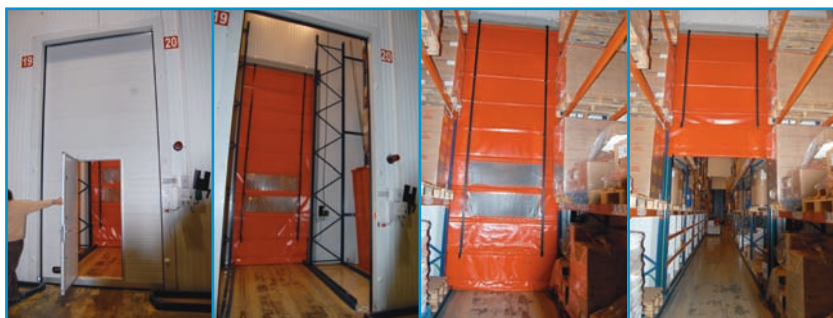
Antecámara sellada por una persiana aislante para un mejor control térmico en una cámara frigorífica industrial.
