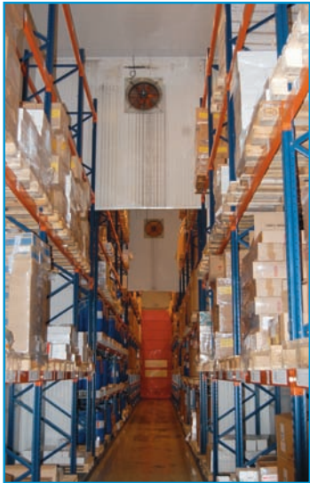
Dada la longitud de la nave, en tramos simétricos se disponen ventiladores de recirculación y checkpoints en los que diferentes sondas realizan mediciones térmicas.
