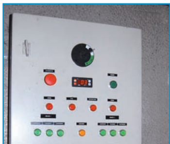
Panel de control del sistema de refrigeración con control de temperatura y aviso de emergencia.
