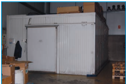
La ubicación de las cámaras frigoríficas y del sistema de refrigeración es muy importante. Nótese como la salida del sistema de refrigeración se ubica en la parte superior, manteniéndose aislada de cualquier elemento que dificulte la recirculación.
