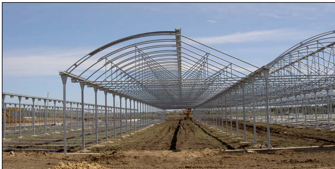
Vista frontale di una nave della serra P-9x4 Fotovoltaico.
