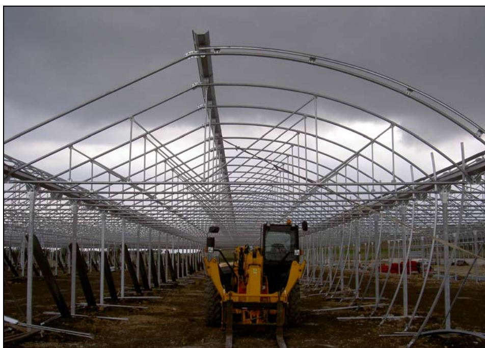
Vista frontale de la nave con la canale di gronda per manutenzione dei pannelli fotovoltaici.
