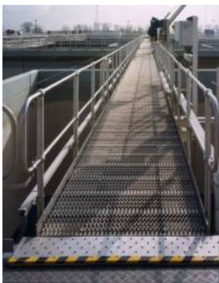
Rejilla STABIL como pasarela en depuradora
