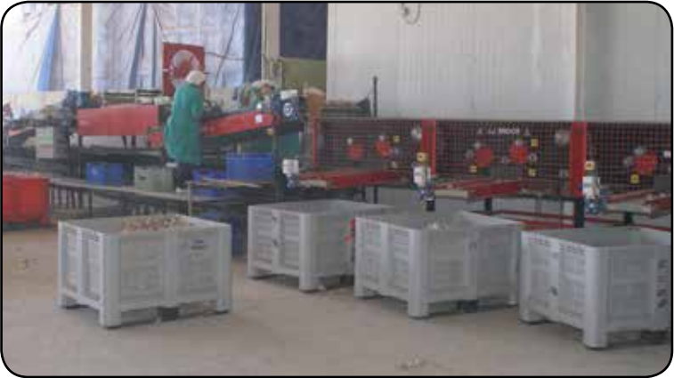
Ligne de réception complète Trémie d'alimentation – nettoyeuse à rouleaux – brosseuse– calibreuse
