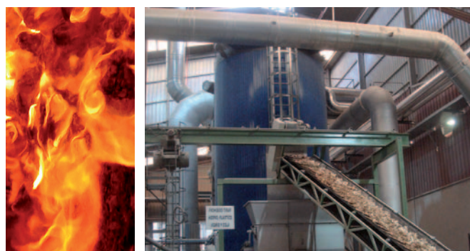
Caldera de biomasa
