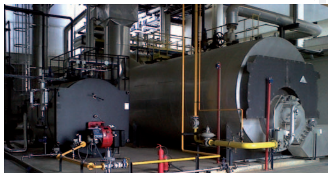
Caldera de vapor
