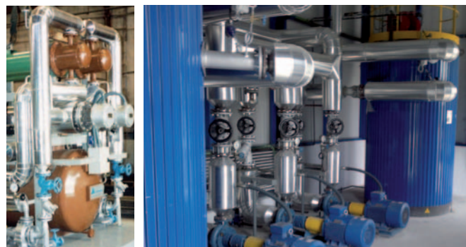
Caldera de aceite térmico
