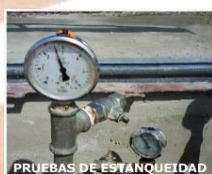
ESTANQUEIDAD EN TUBERIAS Y TANQUES
