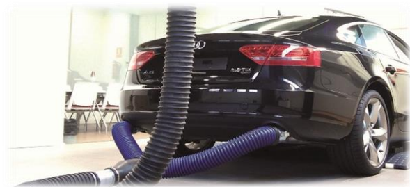
Extracción de gases de escape aéreo.
