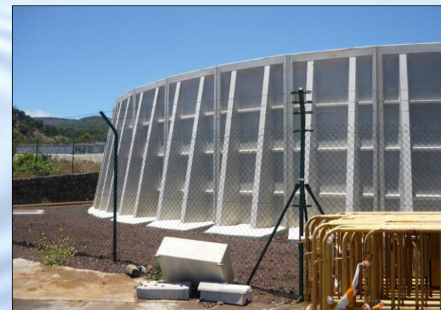
Estación de Bombeo El Helipuerto
