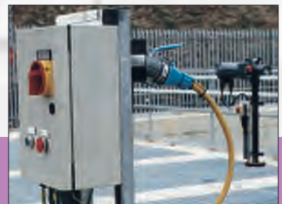
Tratamiento de aguas
