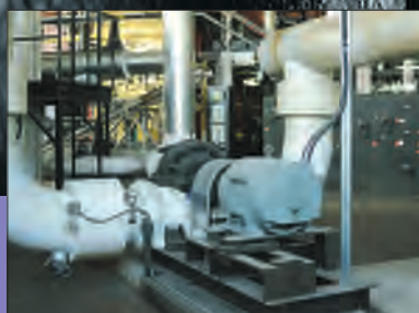
Alimentación de bombas
