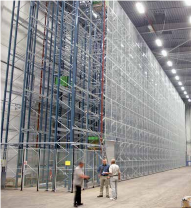
Axelent SafeStore con malla de 50 x 60. Proyecto entregado a Scania en Oskarshamn, Suecia.
