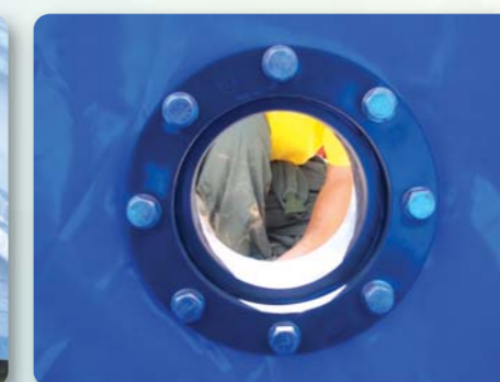
Conexiones de desagüe Drain connections
