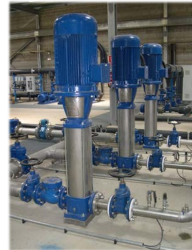
Bombeo de alimentación
