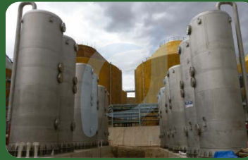
Centrales de bombeo y quema de Biogás
