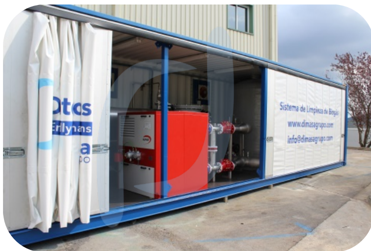
Sistema de Limpieza y Acondicionamiento de Biogás (FINNING / CHILE)
