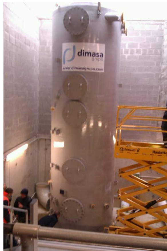
Biofiltro de Sulfuración en EDAR Pineda de Mar (ESPAÑA)
