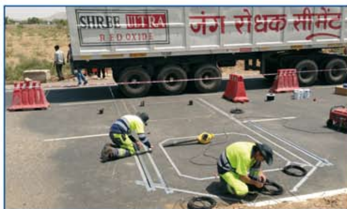
Instalación de aforo piezo - lazo - piezo en Rajastan (India)
