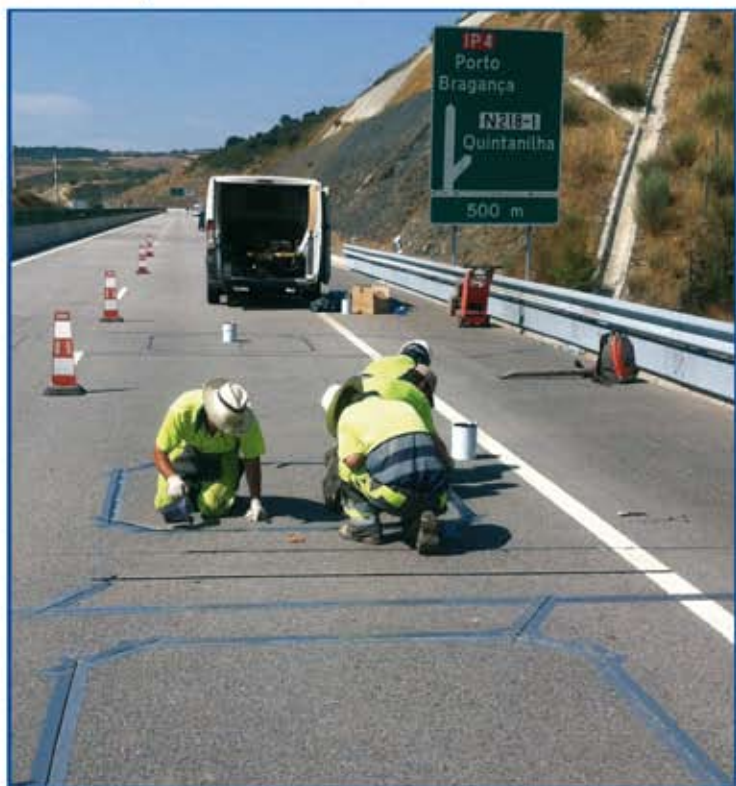
Instalación de aforo y pesaje de alta velocidad con piezos IP4 Portugal
