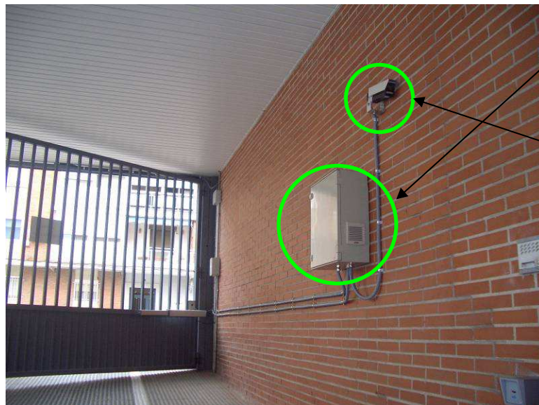
ARMARIO DE CONTROL DEL SISTEMA CON MINIPC, CLIMATIZACIÓN, TARJETA CONTROLADORA DE PUERTAS, ETC Y VIDEO-DETECTOR PARA APERTURA AUTOMÁTICA DE PUERTA CUANDO EL VEHÍCULO
