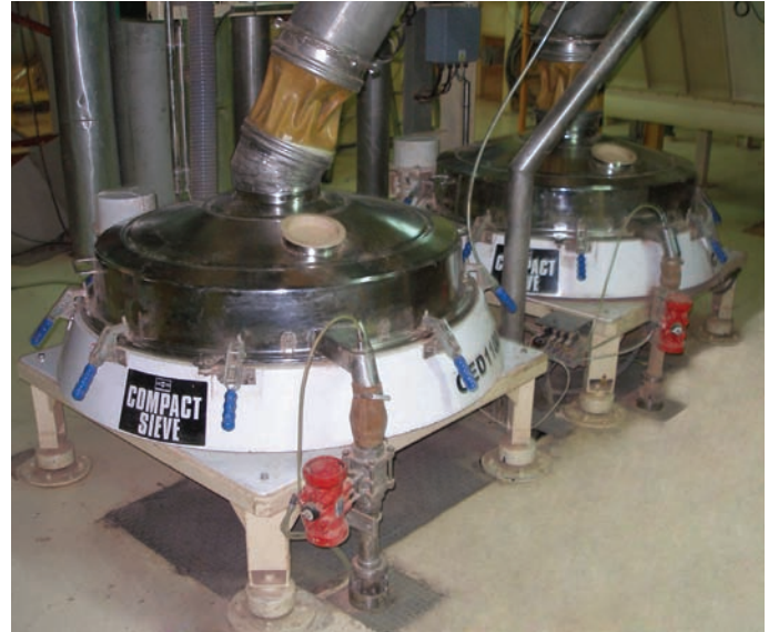
Figura 1: Tamizadoras Russell Compacts instaladas en la planta de Nutrexpa en Barcelona
