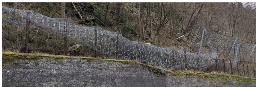
Fig. 14.- Estado de la barrera RXE-500 tras un impacto de altísima energía.
