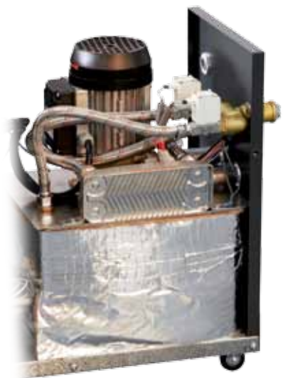
Detalle parte interior unidades de agua Internal view water units
