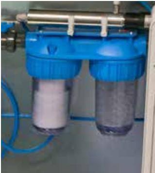
Detalle del sistema de filtración y desbacterización del agua
