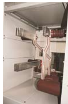
Conducto de barras permitiendo mayor seguridad en el caso de un arco eléctrico.
