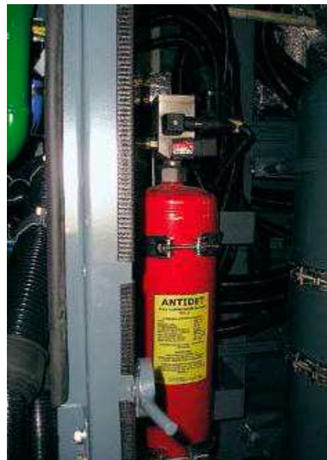
Sistema instalado en zona motor
