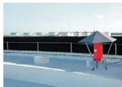
Sistema de extinción
