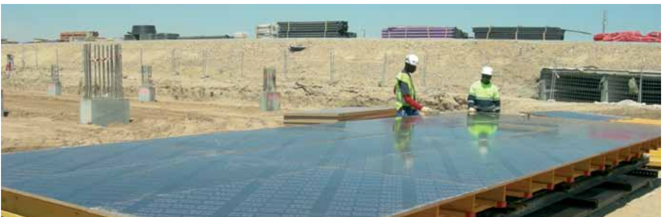
▲ Montaje del encofrado horizontal Mesa VR con tablero fenólico y vigas de madera VM-20.
