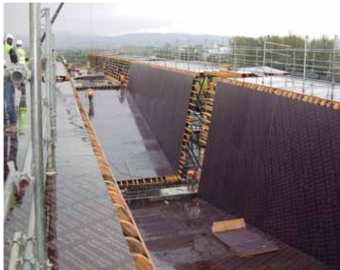
▲ Tablero fenólico como superficie encofrante en el encofrado ENKOFORM H-120 en la ejecución de viaducto
