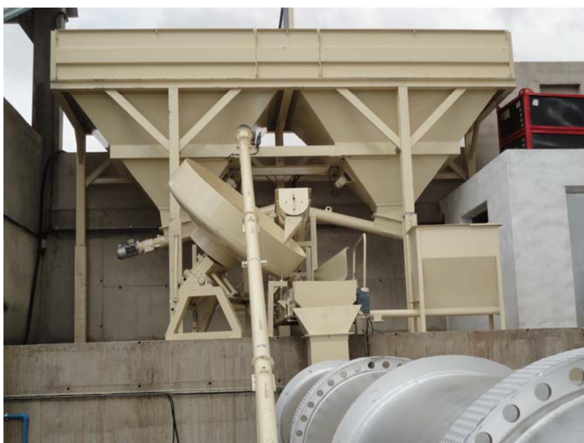
Detalle de tolvas, mezcladora continua y plato granulador
