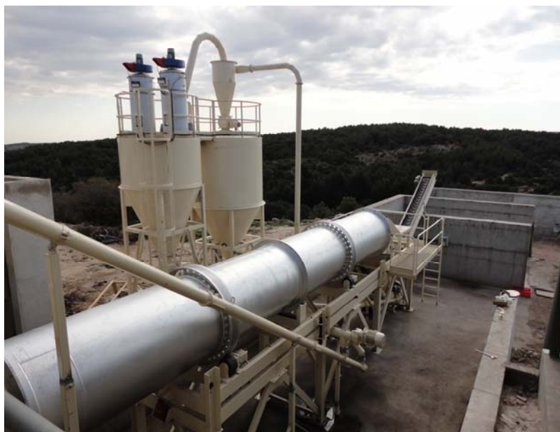
Tromel de secado con silo de acopio al fondo y silos de finos a la Izquierda
