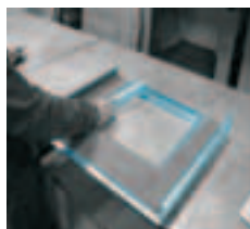
Positionner l'agrafe pour bouche de soufflage qui sera postérieurement fixée à l'aide de rivets.
