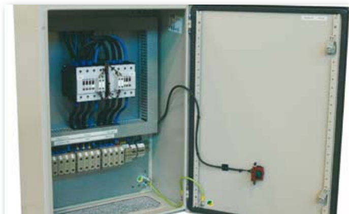
Cuadro de conmutación
