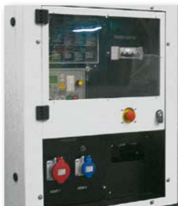
Cuadro protegido por puerta con llave
