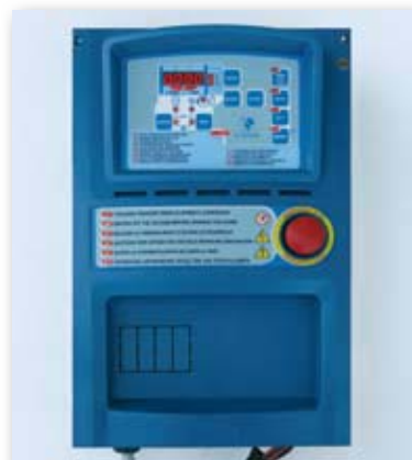
Cuadro automático por fallo de red
