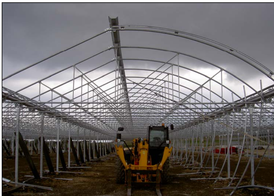
Vista frontal de una nave con la canaleta para mantenimiento de las placas fotovoltaicas.
