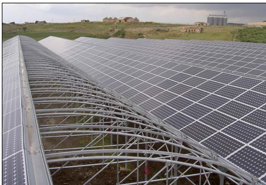
Vista de la cubierta del invernadero con las placas fotovoltaicas.
