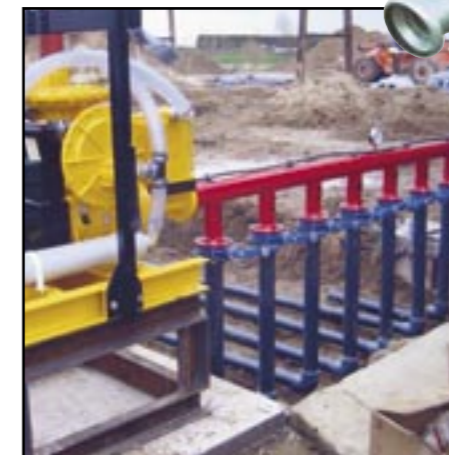
Extracción de agua (RU)
