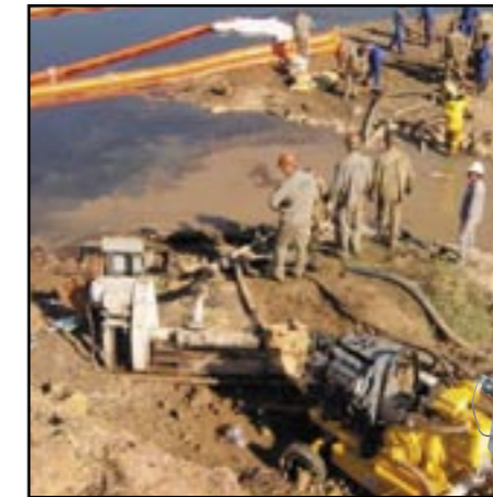
Limpieza de un derrame de hidrocarburos (Venezuela)
