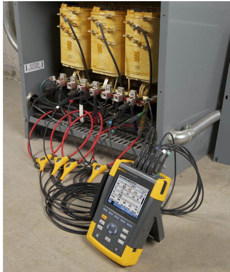
Utilice un registrador como el Analizador de calidad eléctrica Fluke 434 II para medir el coste fiscal de la pérdida de energía debida a una calidad eléctrica deficiente.
