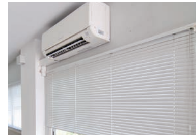
CLIMATIZACIÓN TIPO SPLIT
