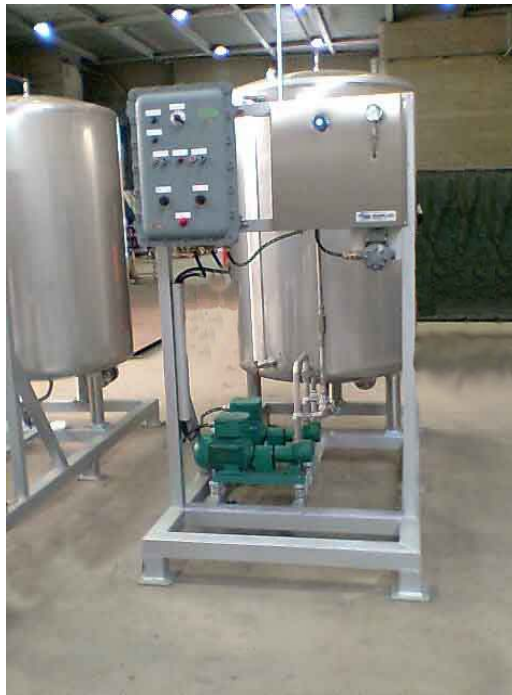
Skid de Aditivación
