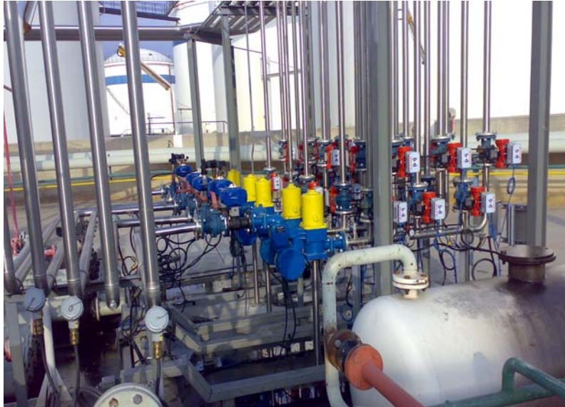
Estación de Carga de Biodiesel
