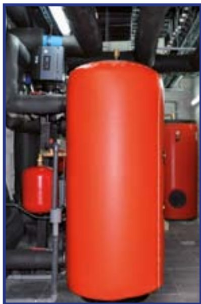
Sala de máquinas desde donde se controla la climatización de las instalaciones.
