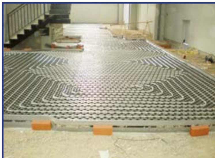
Detalle de los 350 m2 de almacén cubiertos con suelo radiante.
