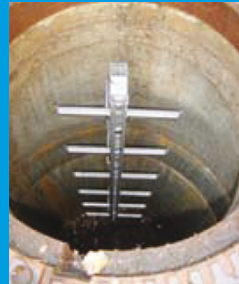
1. Escalera anticaída preinstalada
