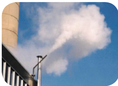
Antes de los purgadores GEM
