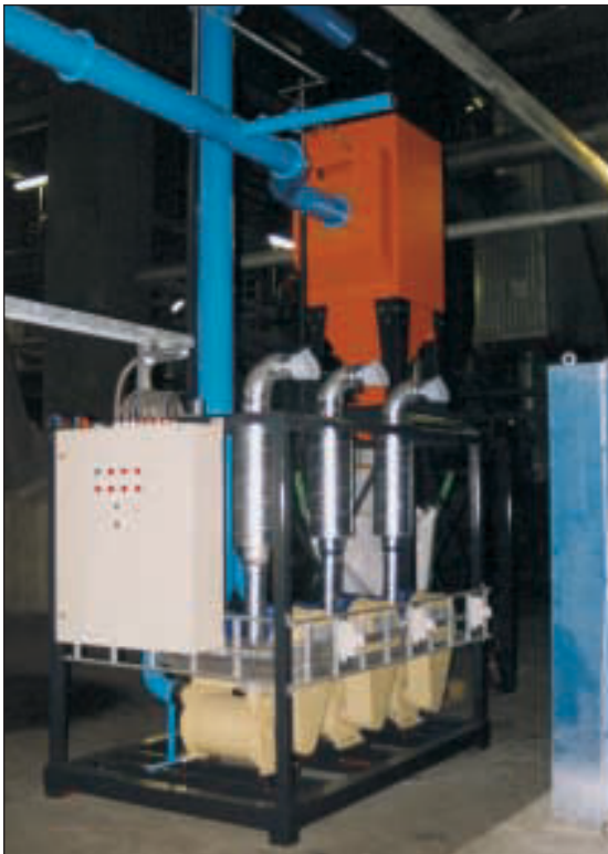
Instalación centralizada de aspiración con varias turbinas en paralelo.
