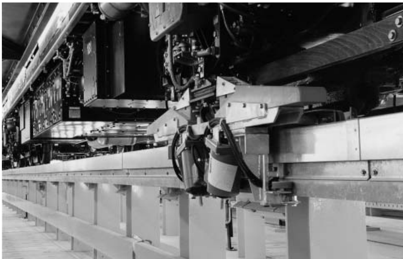
Canal electrificado para tramos de mantenimiento en un ferrocarril metropolitano.
