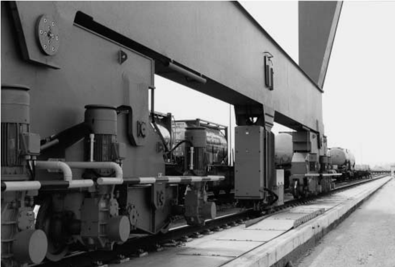
Canal subterráneo-EID en una Terminal de contenedores
