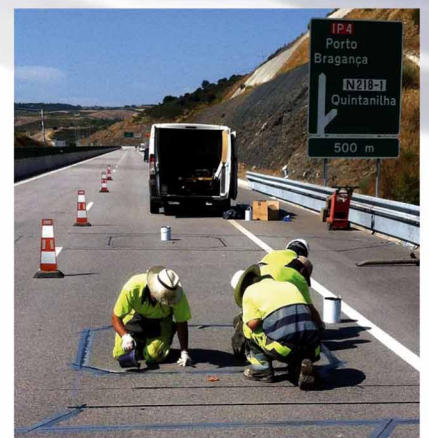
IP4 PORTUGAL: 144 CARRILES DE AFORO Y 44 CARRILES CON PESAJE DINÁMICO A ALTA VELOCIDAD.
