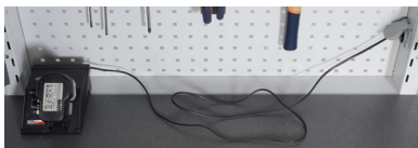
Lío de cables
