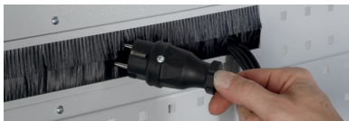
Cables ordenados gracias a la banda de cepillo
