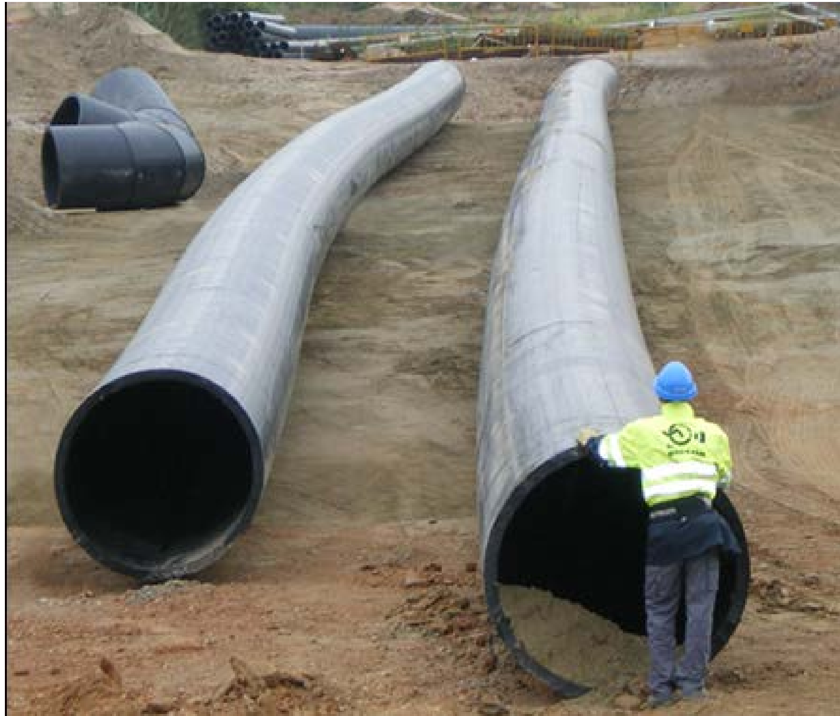
Emisarios enterrados en la desaladora
