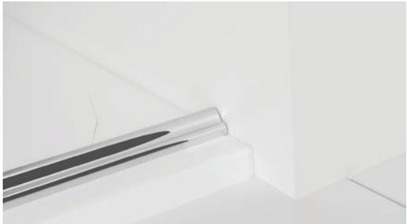
Terminación vierteaguas a pared.
