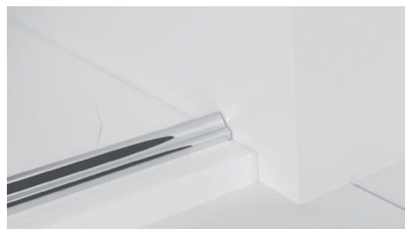
Terminación vierteaguas a pared.
