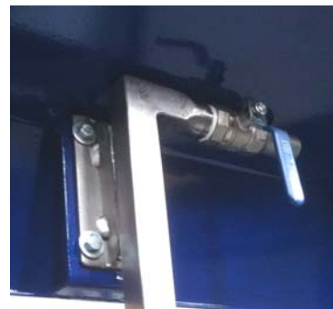
SISTEMA DE APERTURA MANUAL PARA EL ACCIONAMIENTO DE LOS ASPERORES DE AGUA.
