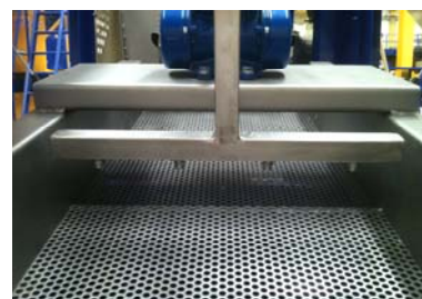
ASPERORES DE AGUA PARA ELIMINACIÓN DE BARRO Y ACLARADO DE LAS ACEITUNAS.
