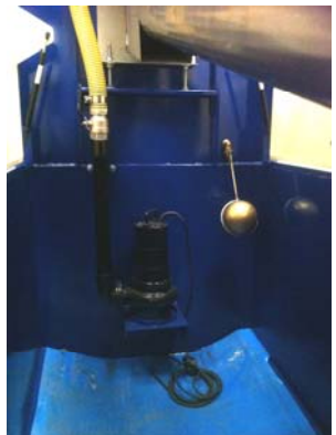
IMPULSIÓN DE AGUA MEDIANTE BOMBA SUMERGIBLE.
