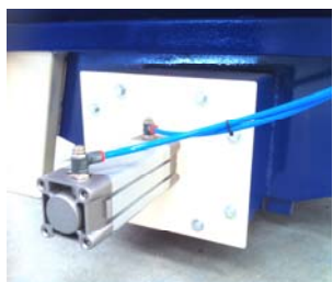
SISTEMA DE APERTURA NEUMÁTICA TEMPORIZADA PARA LA EVACUACIÓN DEL AGUA MEDIANTE DESCARGAS PARCIALES. REBOSADERO INFERIOR DE AGUA.
