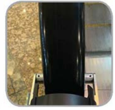
Pasamanos después de limpiar
